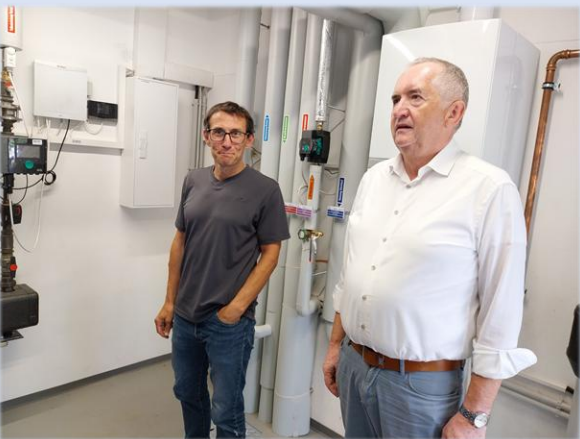
Die Wiederauer Friedrich Ahner GmbH ist ein vielseitiger Handwerksbetrieb auf dem Gebiet der Haustechnik. Firmenchef Matthias Ahner erläuterte Thomas Schmidt eine moderne Lösung zur flexiblen Warmwasserversorgung.
